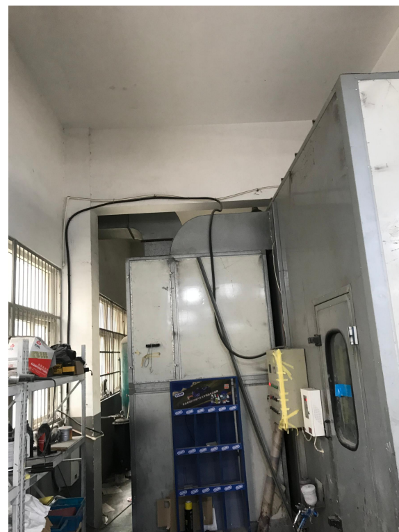
废气处理装置
