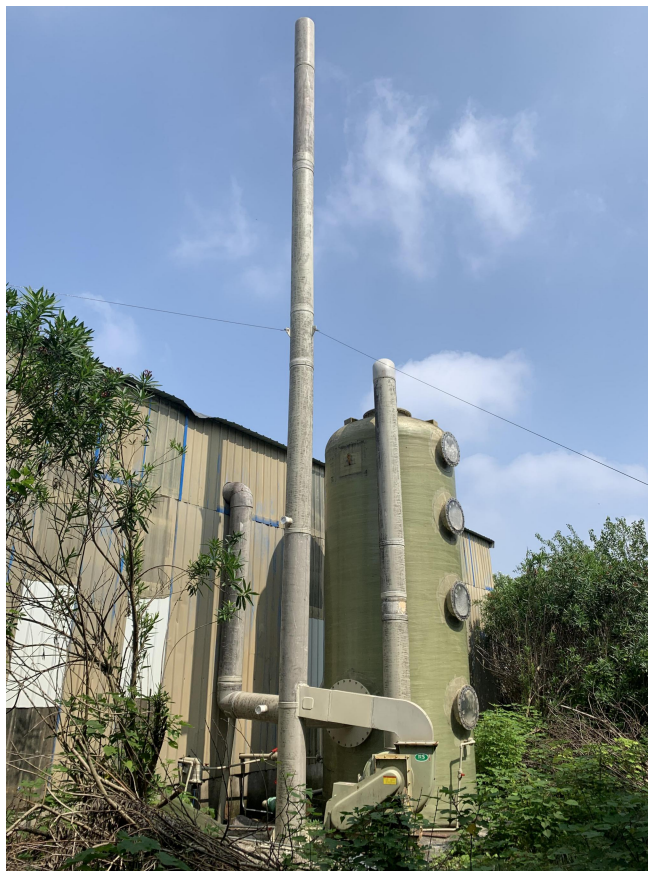
两级喷淋废气处理系统
