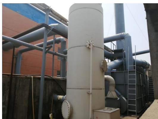
废气处理设施 1
