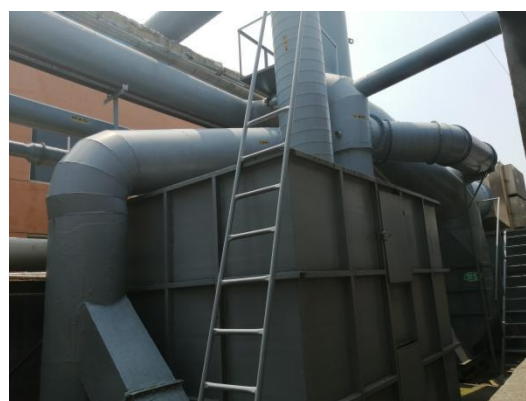
废气处理设施 2
