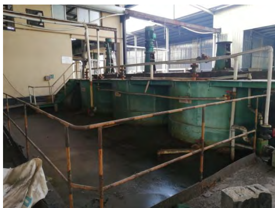
提取车间集水井
