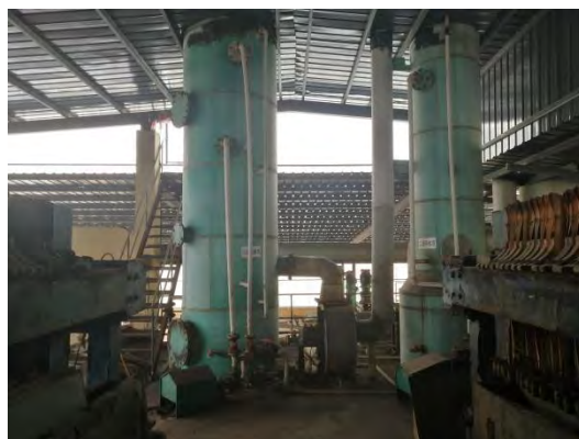
絮凝车间内吸收塔
