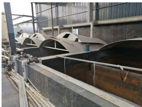
污水处理系统
