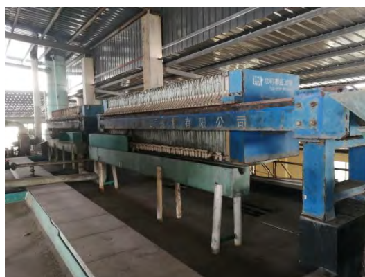
絮凝车间内压滤区
