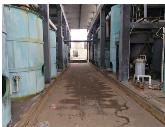
稳定化车间内反应釜
