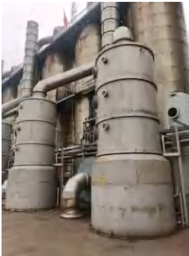
旋风+布袋除尘+喷淋+纳米除臭+生物降解， DA005
