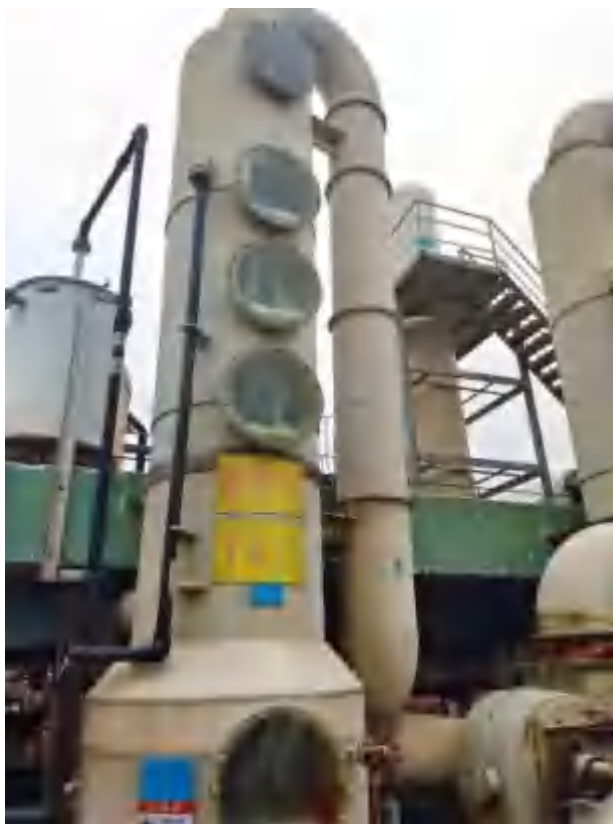
四级喷淋(液碱+尿素或亚硫酸钠)+一级次氯酸钠喷淋, DA017
