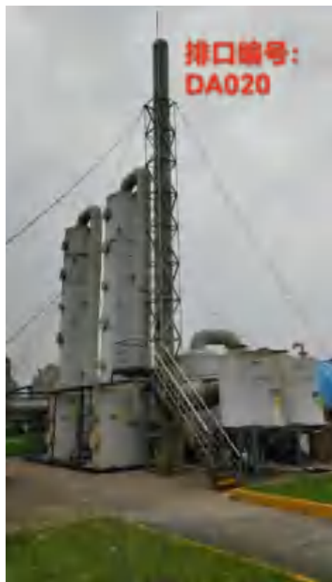
碱液喷淋+次钠, DA020
