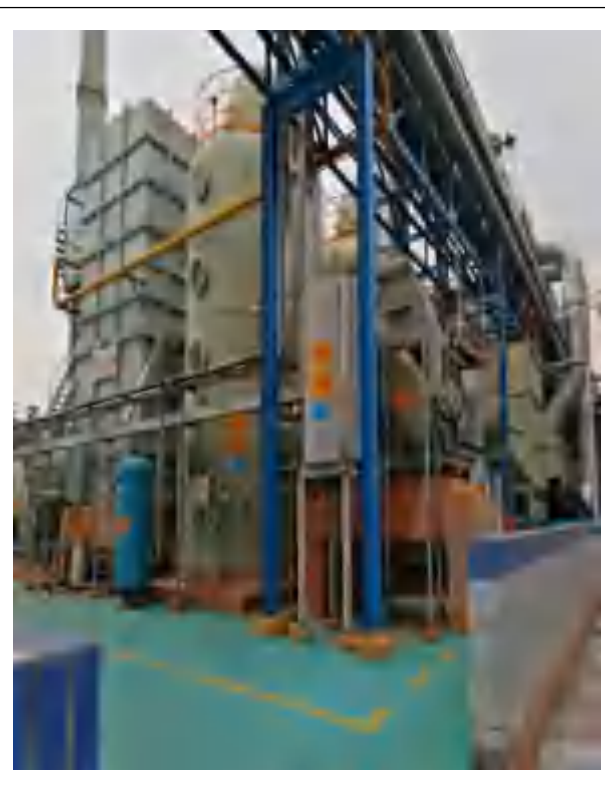
RTO 处理装置
