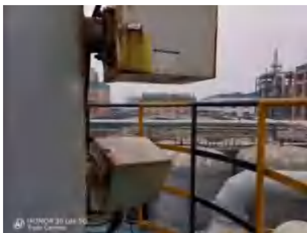
DA015 的废气排放口 VOCs 在线监测装置
