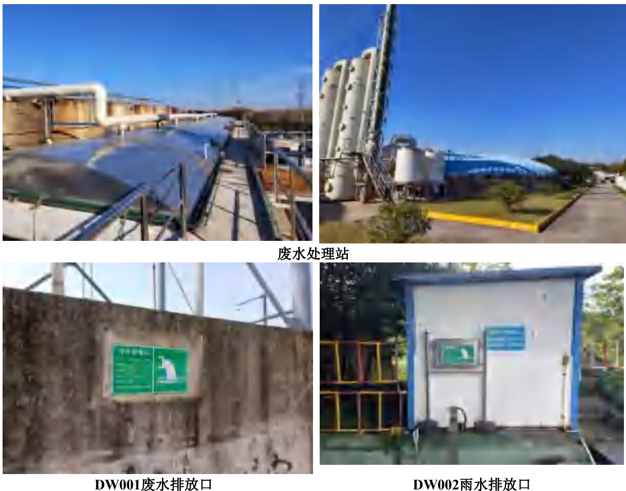
图4.2-2 废水处理站及雨水排放口
