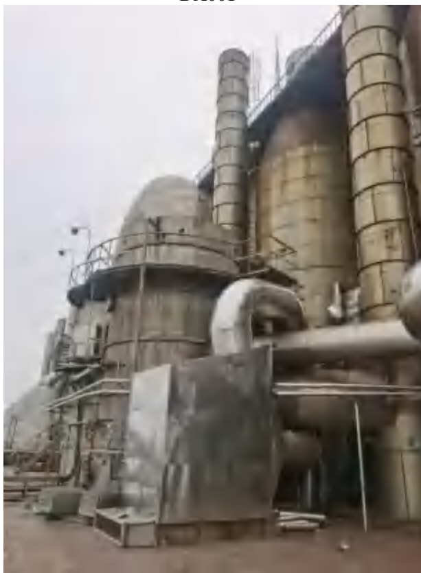
旋风+布袋除尘+喷淋+纳米除臭+生物降解, DA003
