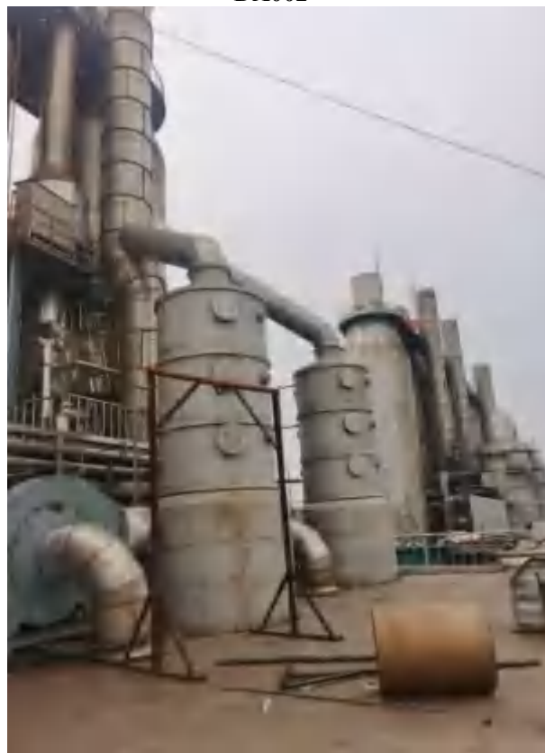
旋风+布袋除尘+喷淋+纳米除臭+生物降解, DA004
