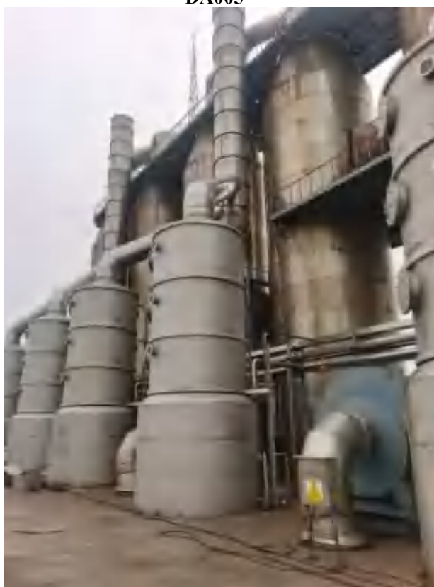
旋风+布袋除尘+喷淋+纳米除臭+生物降解， DA007
