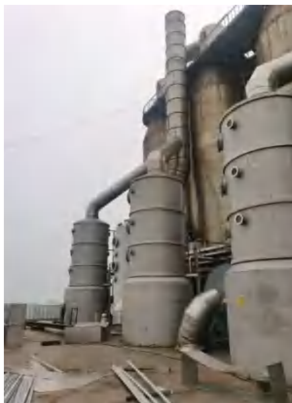
旋风+布袋除尘+喷淋+纳米除臭+生物降解， DA008
