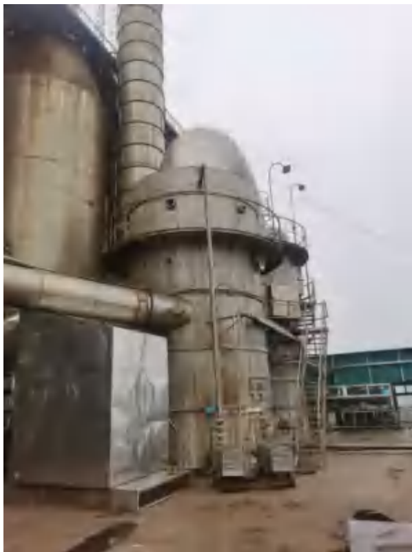
旋风+布袋除尘+喷淋+纳米除臭+生物降解, DA001
