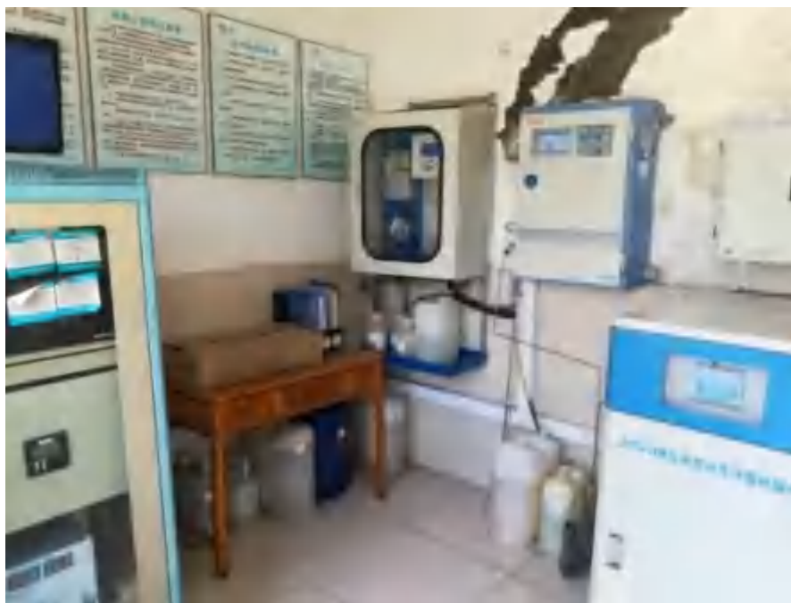
图 4.6-3 废水在线监测装置
