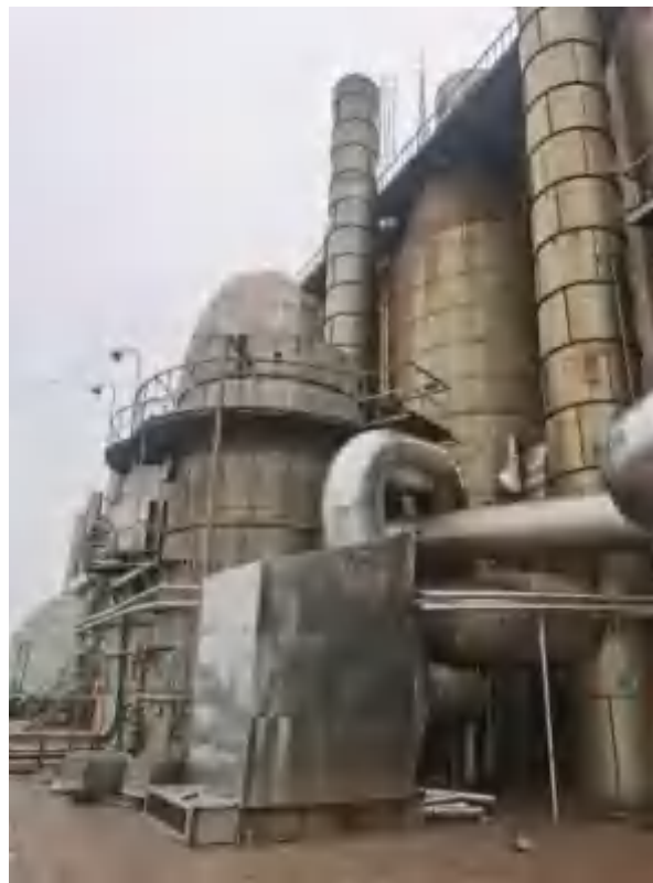
旋风+布袋除尘+喷淋+纳米除臭+生物降解, DA002
