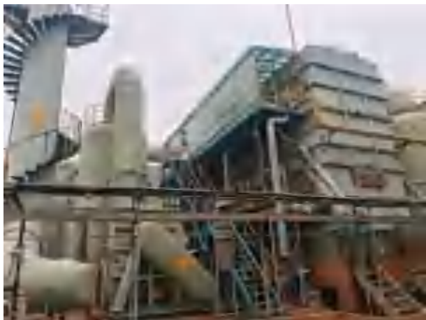
RTO 处理系统, DA022
