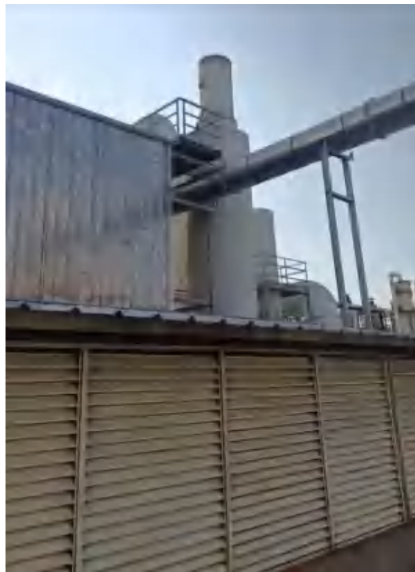
布袋除尘+一级水膜除尘+二级水吸收， DA006
