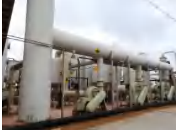
废气处理装置
